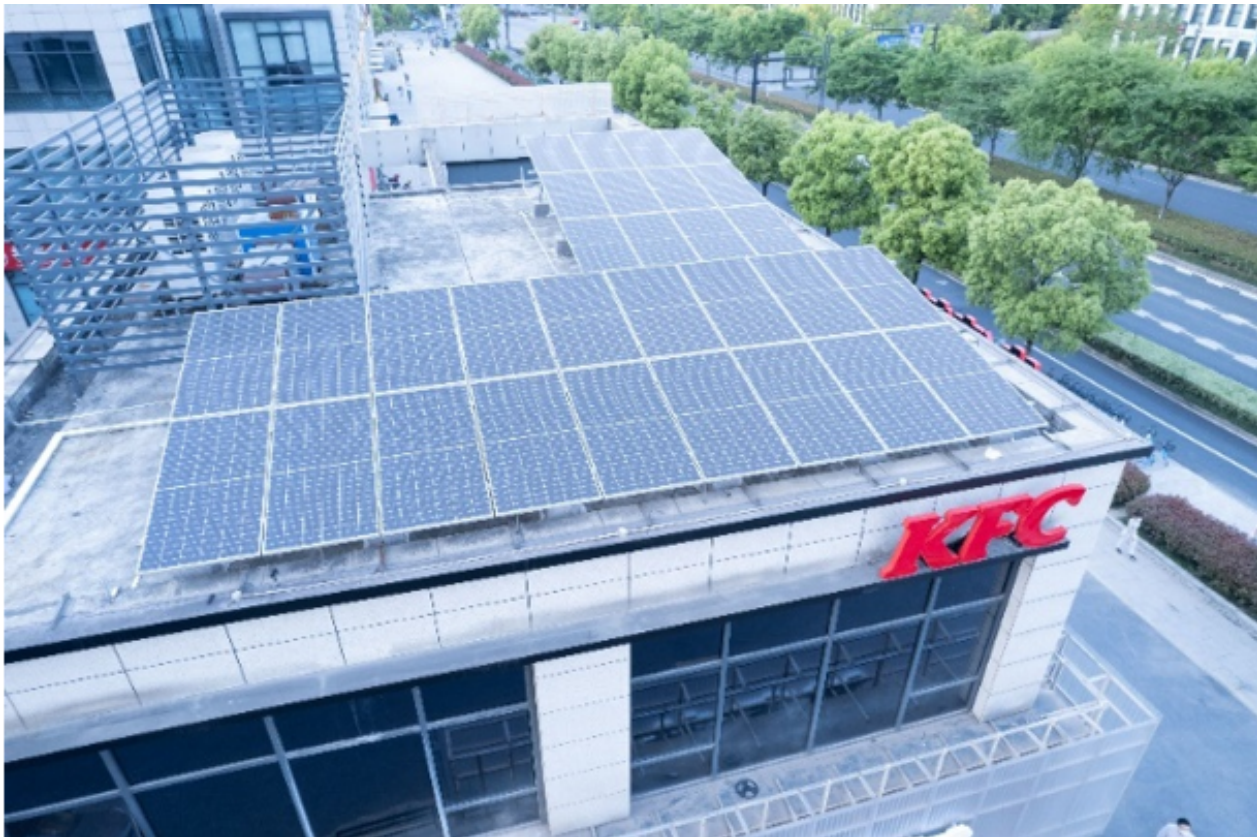
（肯德基「創綠先鋒店」屋頂的光伏系統）
